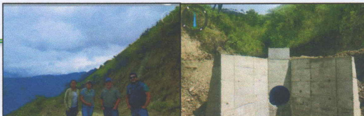
Imagen 06: Observación e inspección de construcción de alcantarillas en la vialidad de la parroquia Tacamoros, en calidad de Administradora del Contrato.
